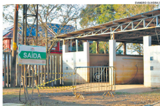
Marcas nas paredes e placas apontam a altura que a água atingiu
